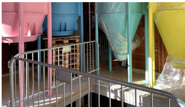
Nouvelles cellules de stockage au moulin panifiable
