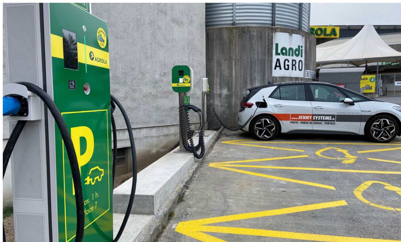
Nouvelles bornes électriques
