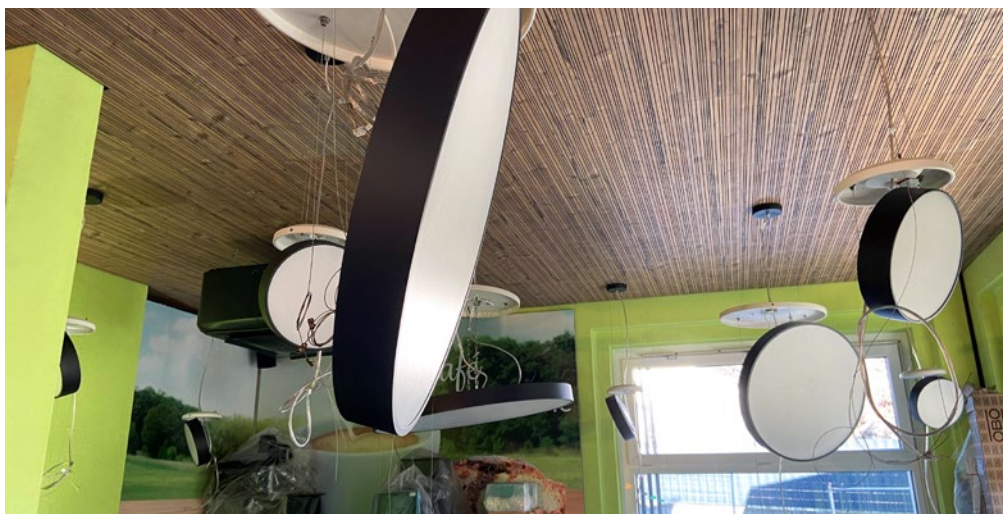
Nouveaux luminaires de la cafétéria du TopShop
