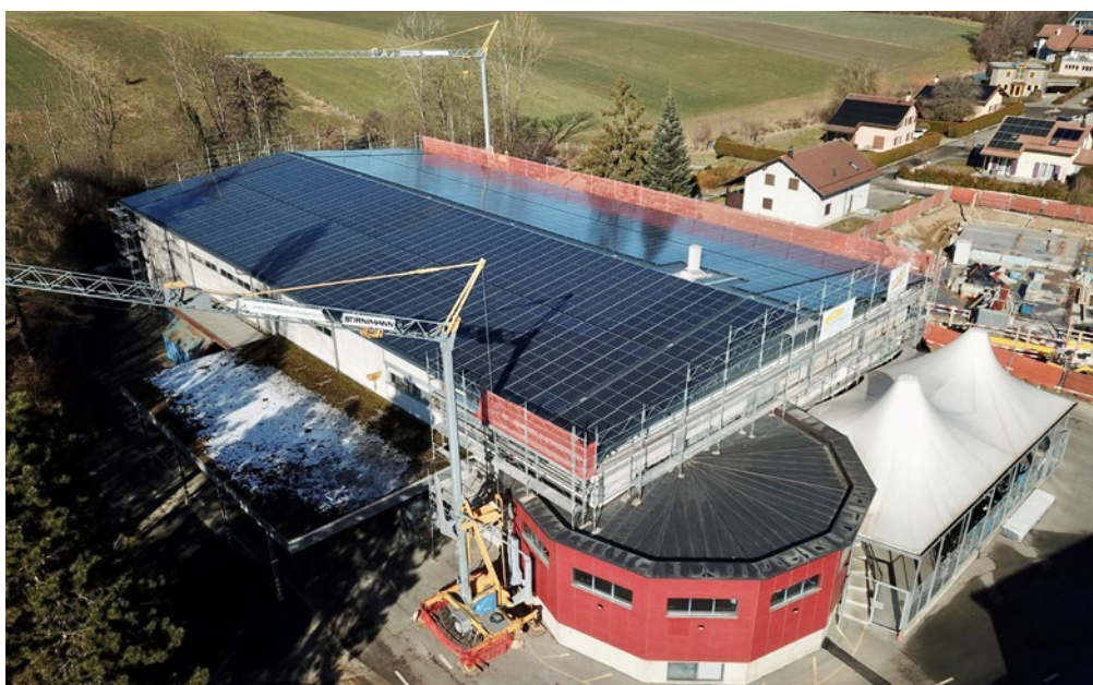
Pose de 2000 m 2 de panneaux photovoltaïques sur le toit de la halle Agro
