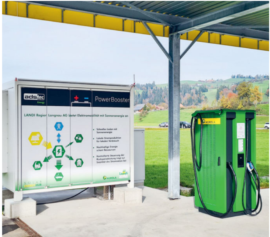
Der lokal produzierte Solarstrom wird optimal genutzt und die Belastung des Stromnetzes minimiert. Bild: LANDI Region Langnau
