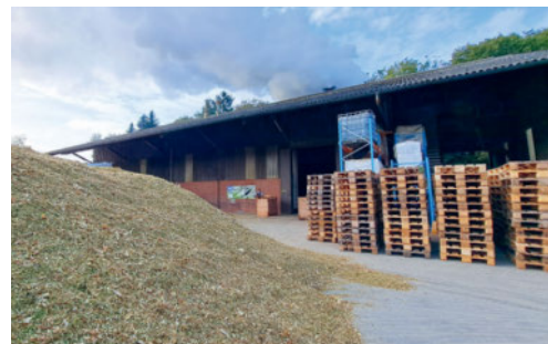
Trocknungsanlage in Betrieb
