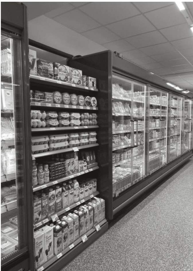
klimafreundliche Kälteanlage im Volg Wängi
