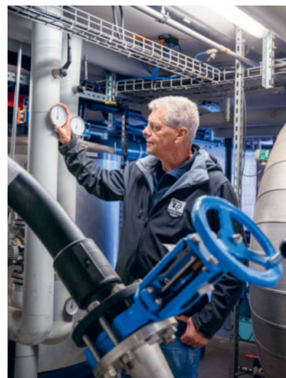
Nebst Paul Julen selbst arbeiten zwei weitere Mitarbeiter in der Biogas-Anlage.
