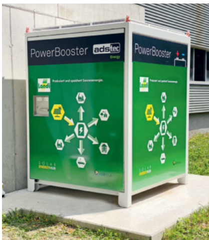
Über den Batteriespeicher werden die Lasten gleichmässig verteilt. Bild: AGROLA
