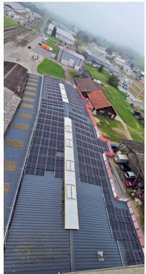
Dank 313 PV-Modulen auf dem Dach kann die Sammelstelle der LANDI Broye-Vully Sonnenenergie nutzen. Bild: LANDI Broye-Vully
