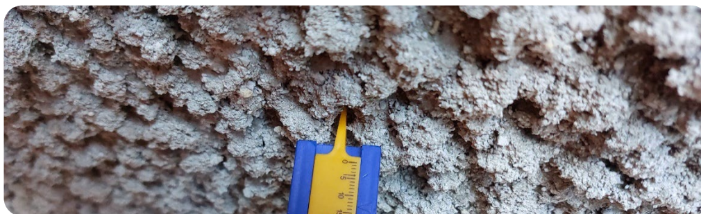
Photo 4 : Rugosités et cratères inacceptables
