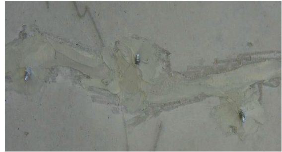
Şekil 1. Soket tipi nipeller çatlakların etrafına yerleştirilir ve MasterStrength® serisinden uygun epoksi yapıştırıcı ile kapatılır.
