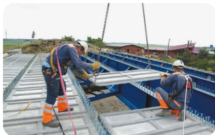
Układanie płyt z UHPC z dodatkiem mikrodrucików MasterFiber 482 na wiadukcie autostradowym niedaleko Benátek n/).
