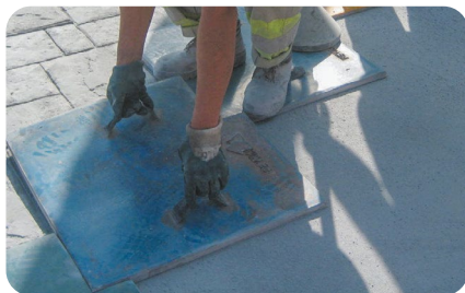
Powierzchnia komunikacyjna z elementów imitujących kamień łupany z betonu z makrowłóknami MasterFiber 235 SPA.
