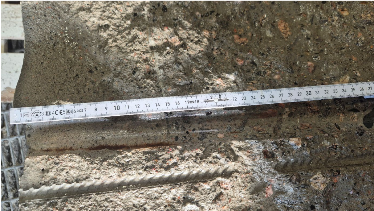
Bild 4: Anslutning mellan armering och betong såg bra ut. vid andra armeringsraden med hänsyn till gjutrörets placering
