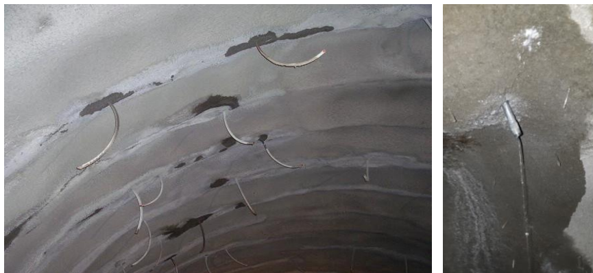
Photo 11 : Système de drainage - trous de 10 mm de diamètre contenant des injecteurs avec tuyaux en PVC, avant application du MasterRoc MSL 345 & Photos d'un injecteur utilisé comme un drain.
