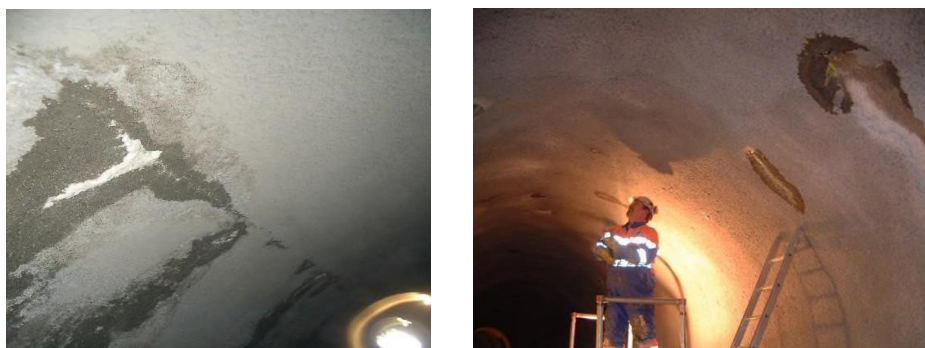
Photos 12 : Fissures injectées avec de la mousse polyuréthane et points ponctuels injectés avec un gel acrylique
