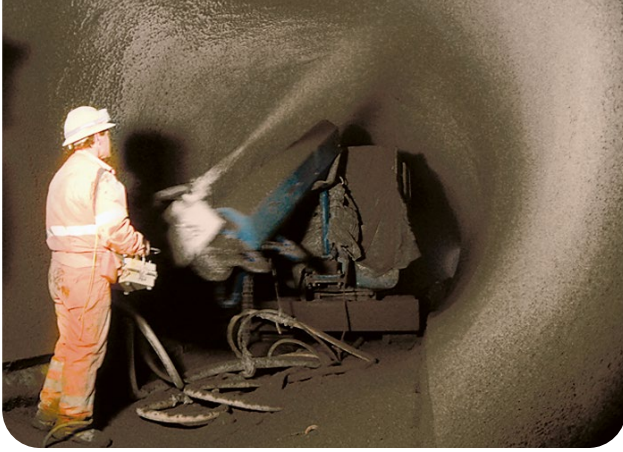
Auftragen der inneren Betonschale mit Nassspritzbeton. Zu beachten ist der horizontale Streifen im unteren Wandbereich, der nicht überspritzt wird. Dieser Streifen dient dem Anschluss der später gespritzten Sohlmembran.
