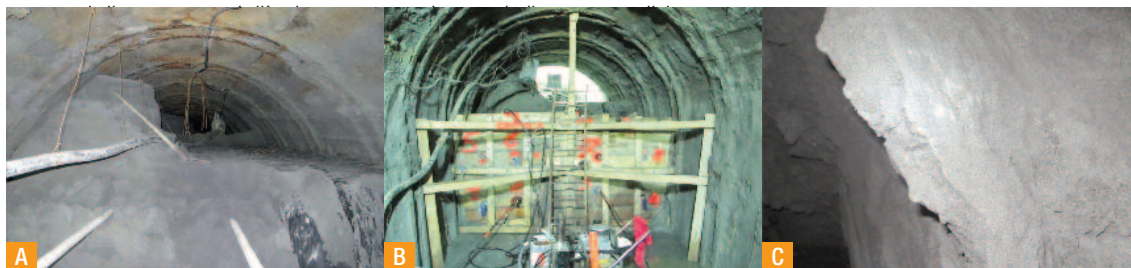
A) Fronte sabbioso prima dell'intervento
