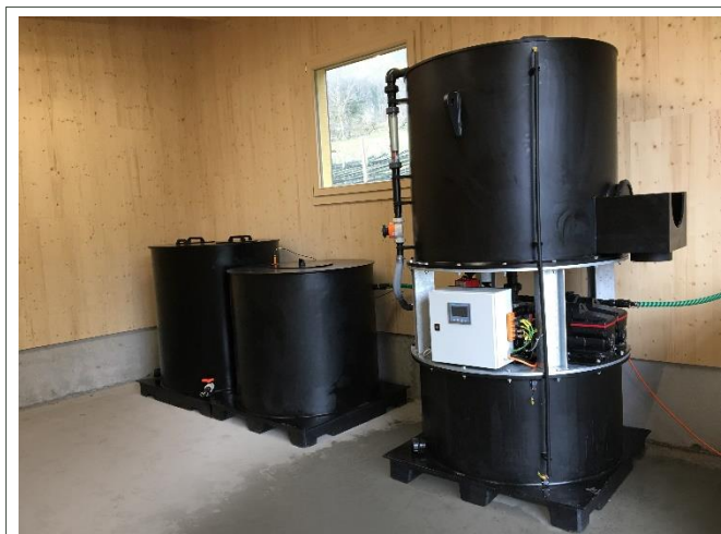
Aktivkohlefilter-Anlage mit dem Partikelfilter-Modul (Behälter links), dem nachgeschalteten Speichertank (mittig) sowie dem PSM-Modul mit der Aktivkohle (Säule rechts). Foto: S. Schäfer.
