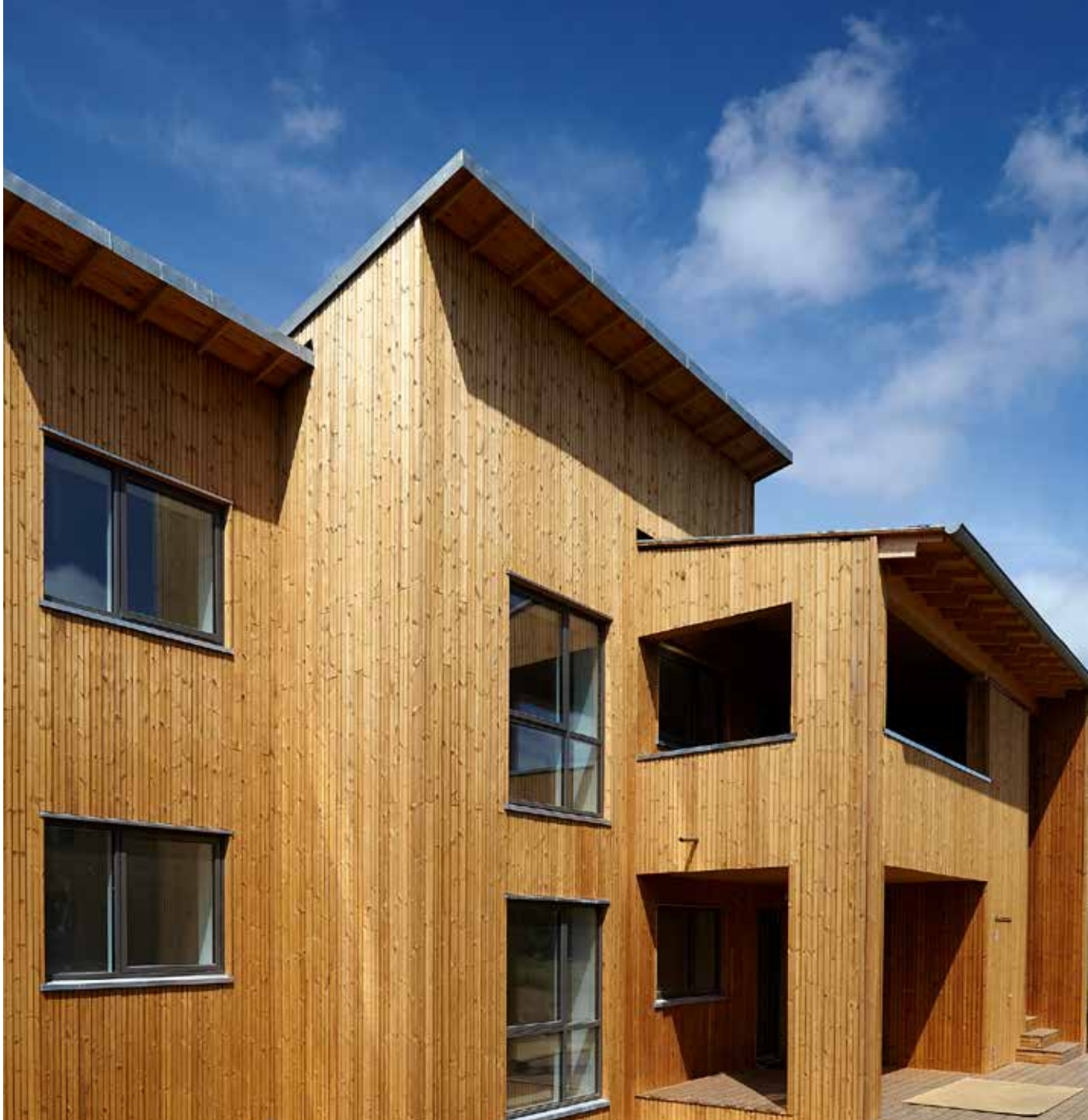
Under beklædningen på facaden er der en vindspærreplade, som forhindrer en brand i at sprede sig fra facaden ind i bygningen.
