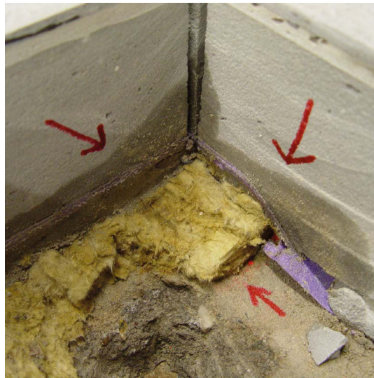
Fette, Öle, Reinigungsmittel und deren Abbauprodukte haben den Estrich getränkt und anschließend darunter liegende Schichten angegriffen.
