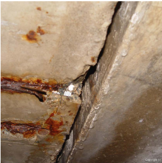
Der Bewehrungsstahl ist stark durch Milchsäure und andere Stoffe korrodiert und kann die Standsicherheit nicht mehr gewährleisten.
