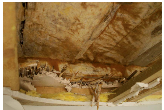
Die Holzbalkendecke ist durchfeuchtet und durch einen pflanzlichen Holzschädling befallen. Die Standsicherheit ist nicht mehr gegeben.
