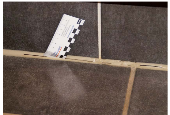
Undichte, abgerissene Silikonfugen sind oftmals die Ursache für einen Feuchteintrag in die Konstruktion.
