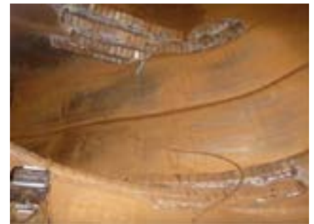
Revêtement d'usure en acier AR avec réparations
