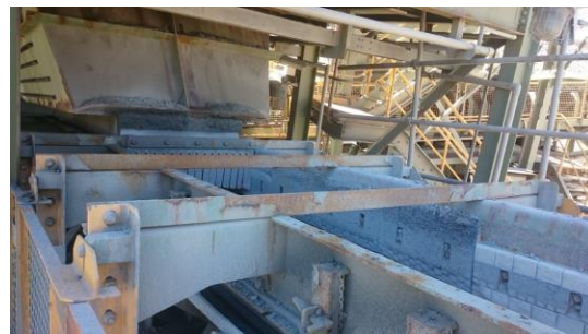
Goulotte de déchargement constituée de blindages
