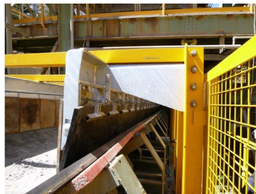
Vue d'extrémité de l'installation du système rotatif
