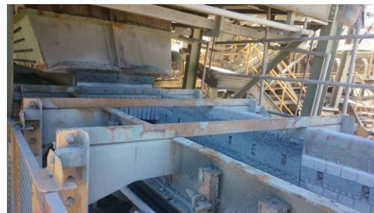
Разгрузочный желоб с установленными бортовыми футеровками
