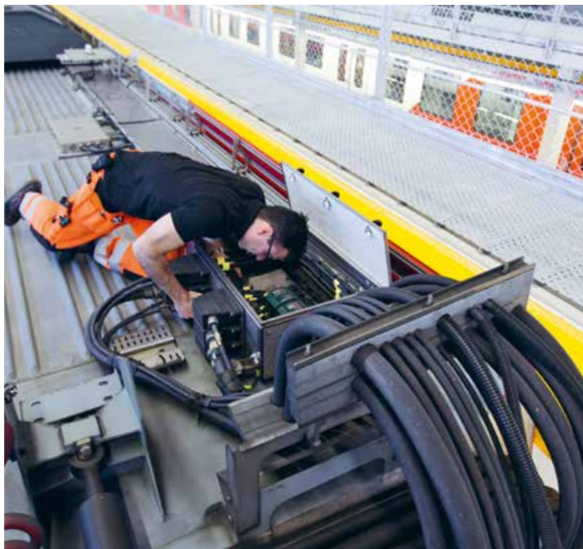
Boxholms Depå, belägen söder om Linköping, färdigställdes under året. Nu underhålls ÖstgötaTrafikens tåg trafiknära i en depå som till fullo är anpassad efter moderna tågs behov. Bland annat finns mycket av elektroniken på taket på nyare tåg, vilket ställer höga krav på mycket god elsäkerhet.
