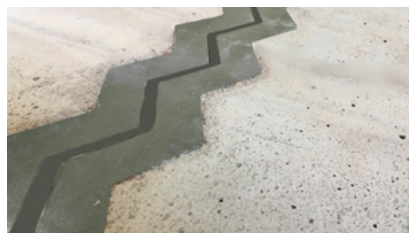
Fugenaufweitung nach dem Schwinden
