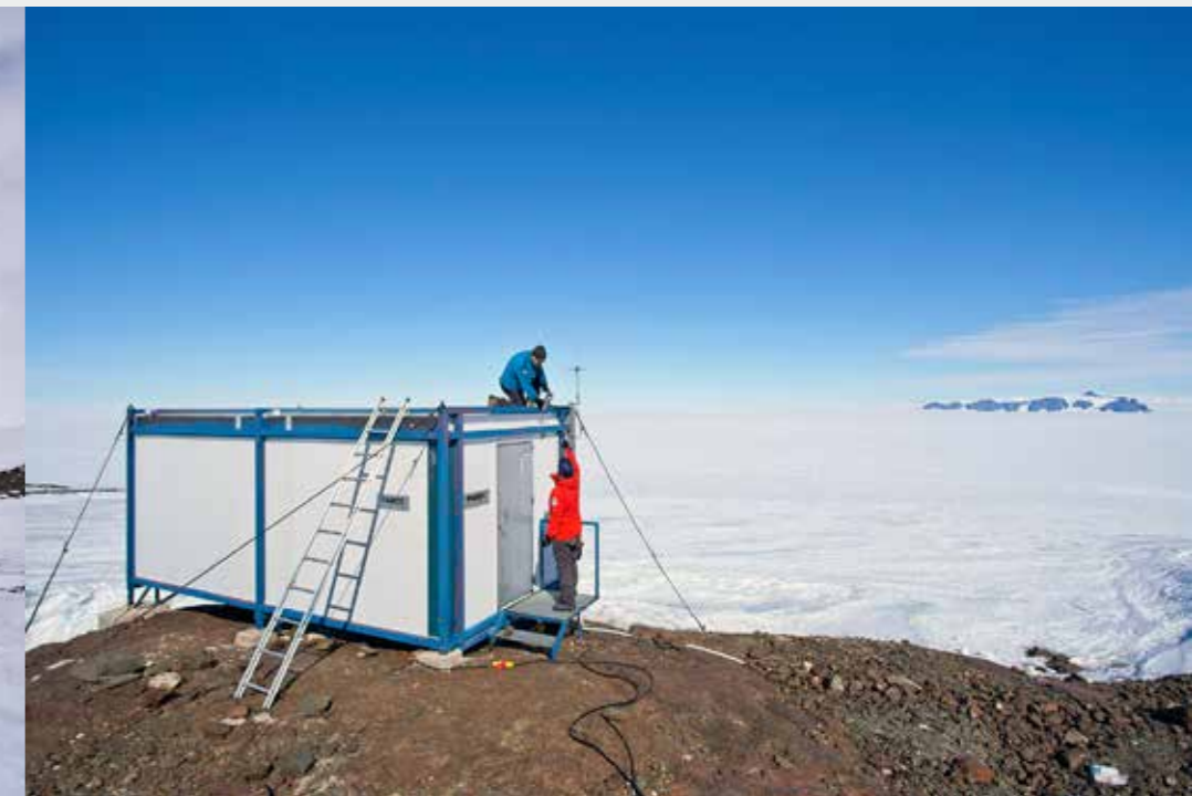
RTK-GPS antennin asennustöitä geokontilla. Installation work of the RTK-GPS antenna at the Geo-container. Kuva | Photo: Pasi Ylirisku
