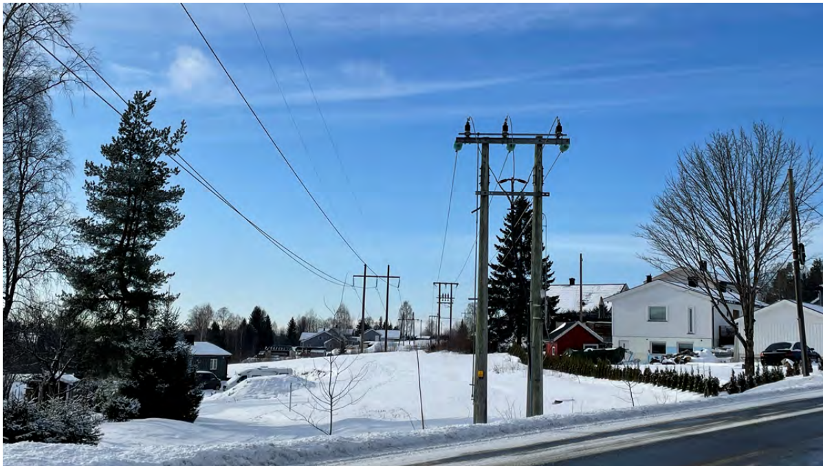
Figur 9: Eksisterende 66 kV Dal-Hovinmoen ut fra Dal transformatorstasjon til venstre og 22 kV kraftledningen til høyre i bildet.
