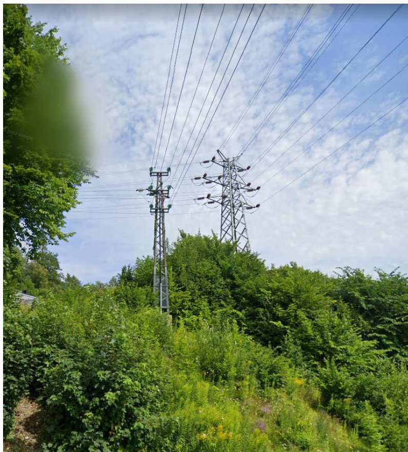
Fig 1. 22 kV og 47 kV master
