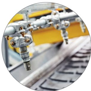
System ochrony przeciwpożarowej
