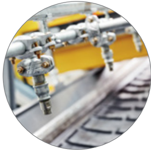
Sistema de extinción de incendios
