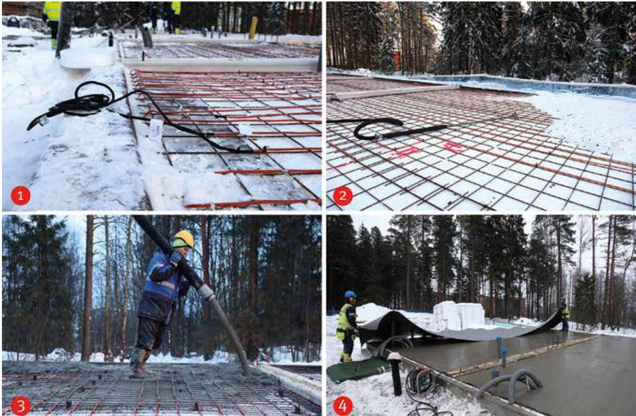
Kuva 7 Talvibetonoinnin vaiheet BET-lämmityskaapeilla 1: BET-lämmityskaapelin asennus 2: jään ja lumen sulatus 3: betonin valu, jonka jälkeen BET-lämmityskaapeleiden kytkeminen päälle 4: valun suojaaminen
