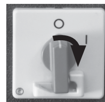
Inschakelen van de hoofdschakelaar
