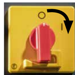
Einschalten des Hauptschalters
