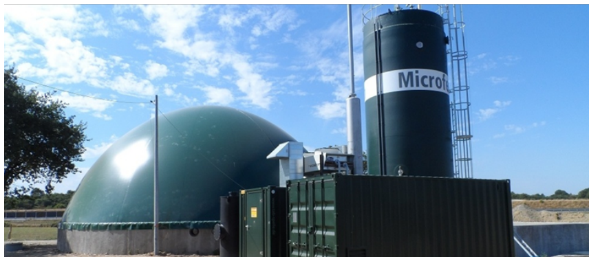
Slika 1.2: Biogasno postrojenje sa pripremom tečne sirovine, fermentorom, kontrolnim kontejnerom i CHP-om
