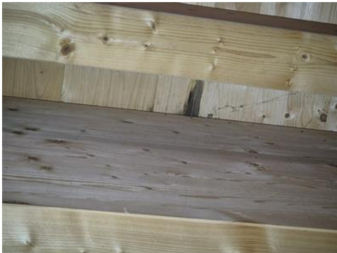
Missfärgning vid takfot.
