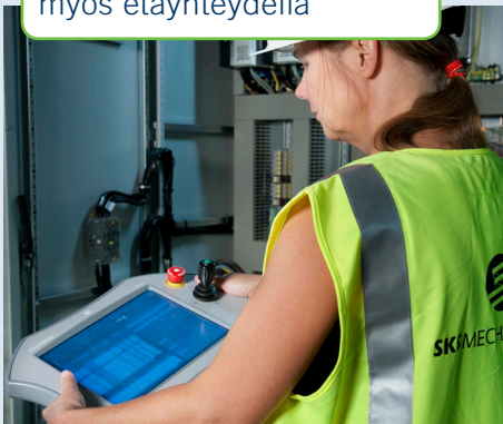
Huolto- ja kunnossapito myös etäyhteydellä
