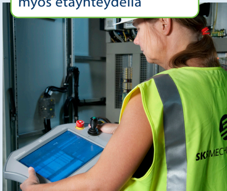
Huolto- ja kunnossapito myös etäyhteydellä
