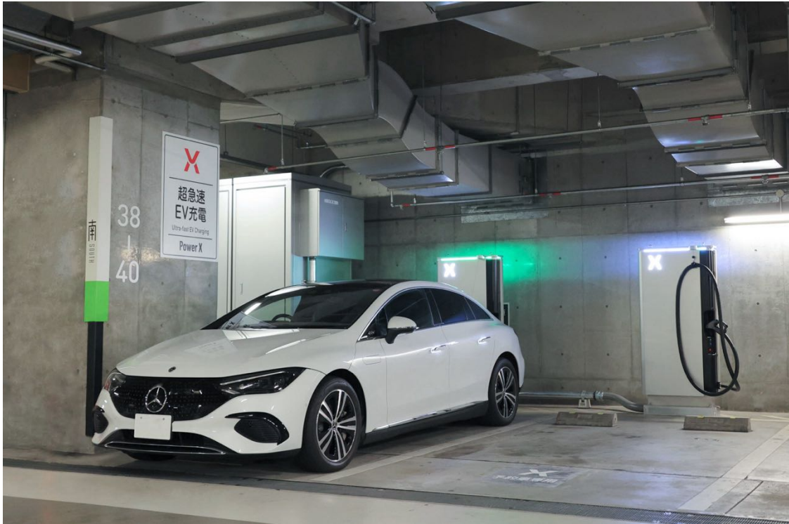
画像：グランフロント南館駐車場内の充電ステーション 車両：メルセデス・ベンツ EQE 350+
