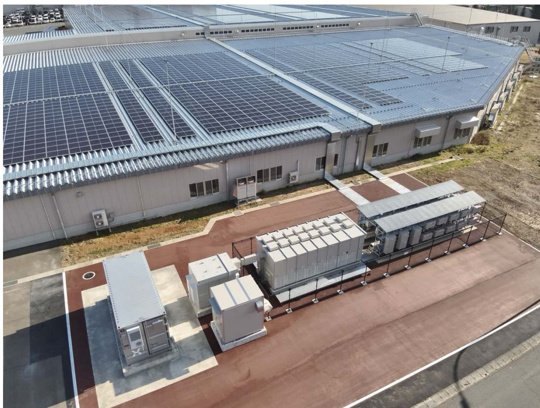
画像：岩手工場に設置の太陽光発電設備と蓄電システム（提供：トヨタ自動車東日本）
