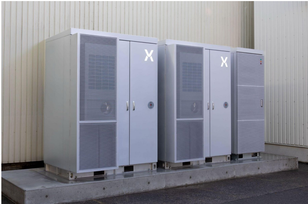
ウヤマ産業野田流通加工センターに納入した中型蓄電池2台（総蓄電容量：716kWh）
