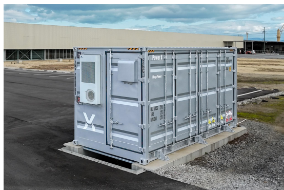
パワーエックスの蓄電システム
