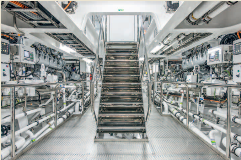
Ungewöhnlich: ein Maschinenraum über zwei Ebenen auf einer 66-Meter-Yacht. Die Installation aller technischen Komponenten hat höchstes Niveau.
