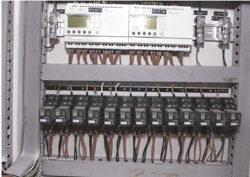
Modifikasi pengkabelan pada body kendaraan perlu menghitung kebutuhan arus listrik
