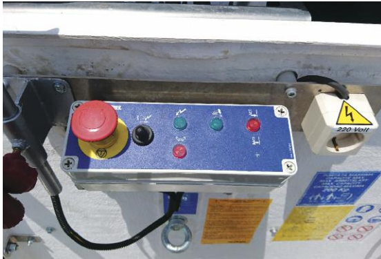
Panel kontrol pada basket
