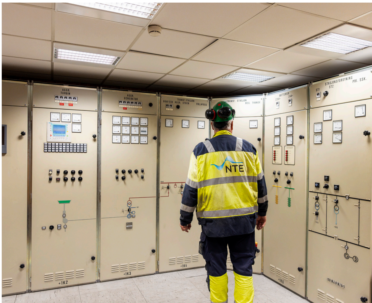
Tore Saasen i kontrollrommet i Ormsetfoss kraftverk
