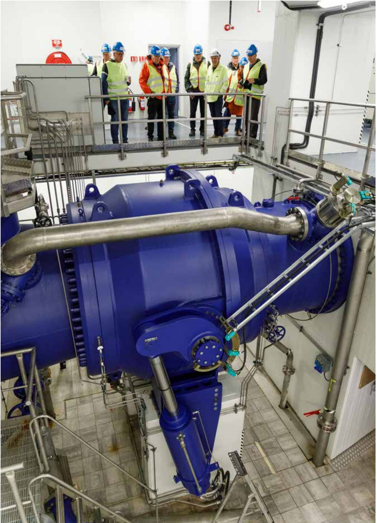
Åpen dag på Follafoss kraftverk
