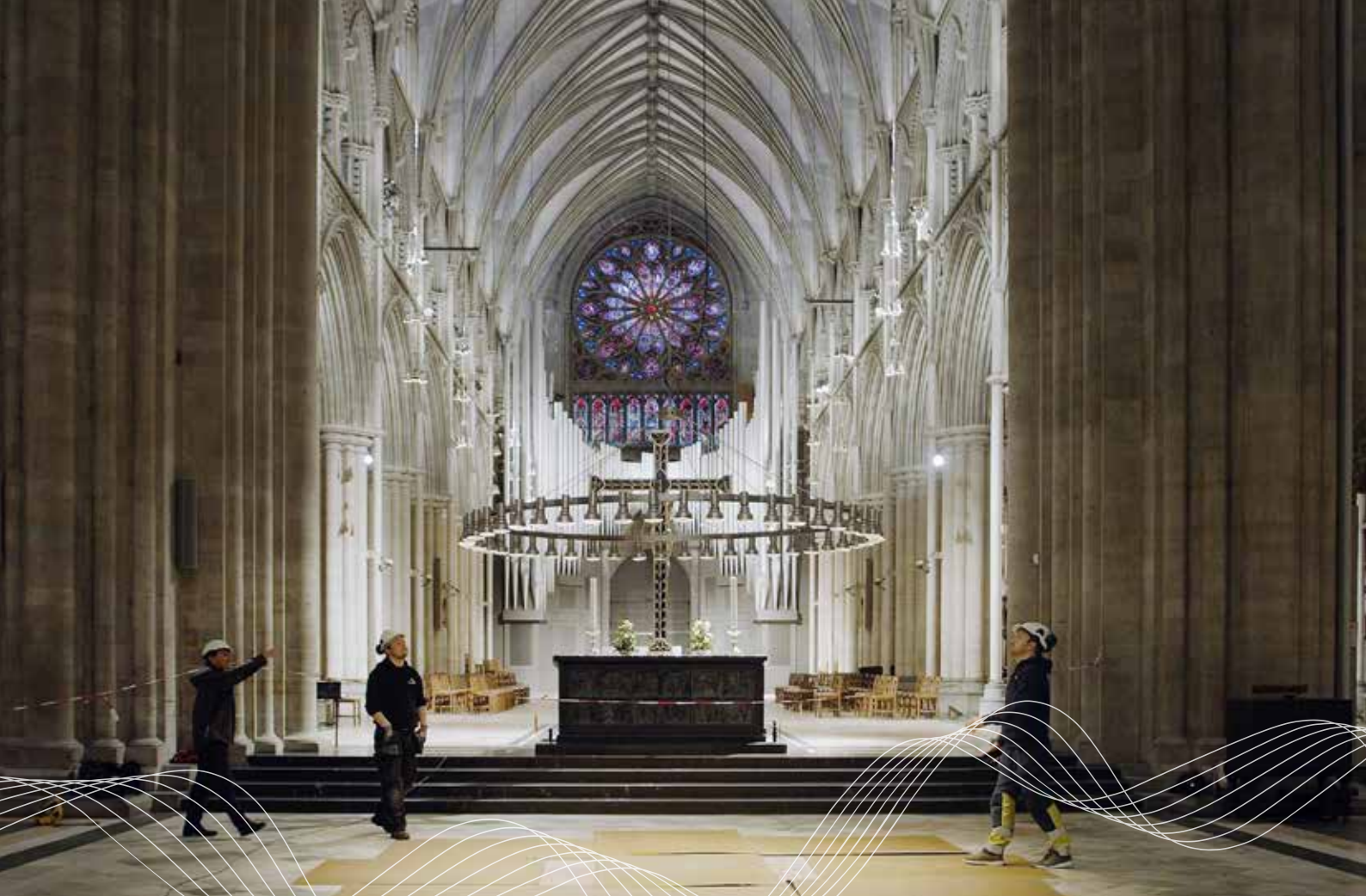
NTE installerte ny belysning i Nidarosdomen. Prosjektet, som var et samarbeid med lysdesigner Erik Selmer, har vunnet flere priser, blant annet den prestisjetunge ALD Award of Excellence. Foto: Berre
