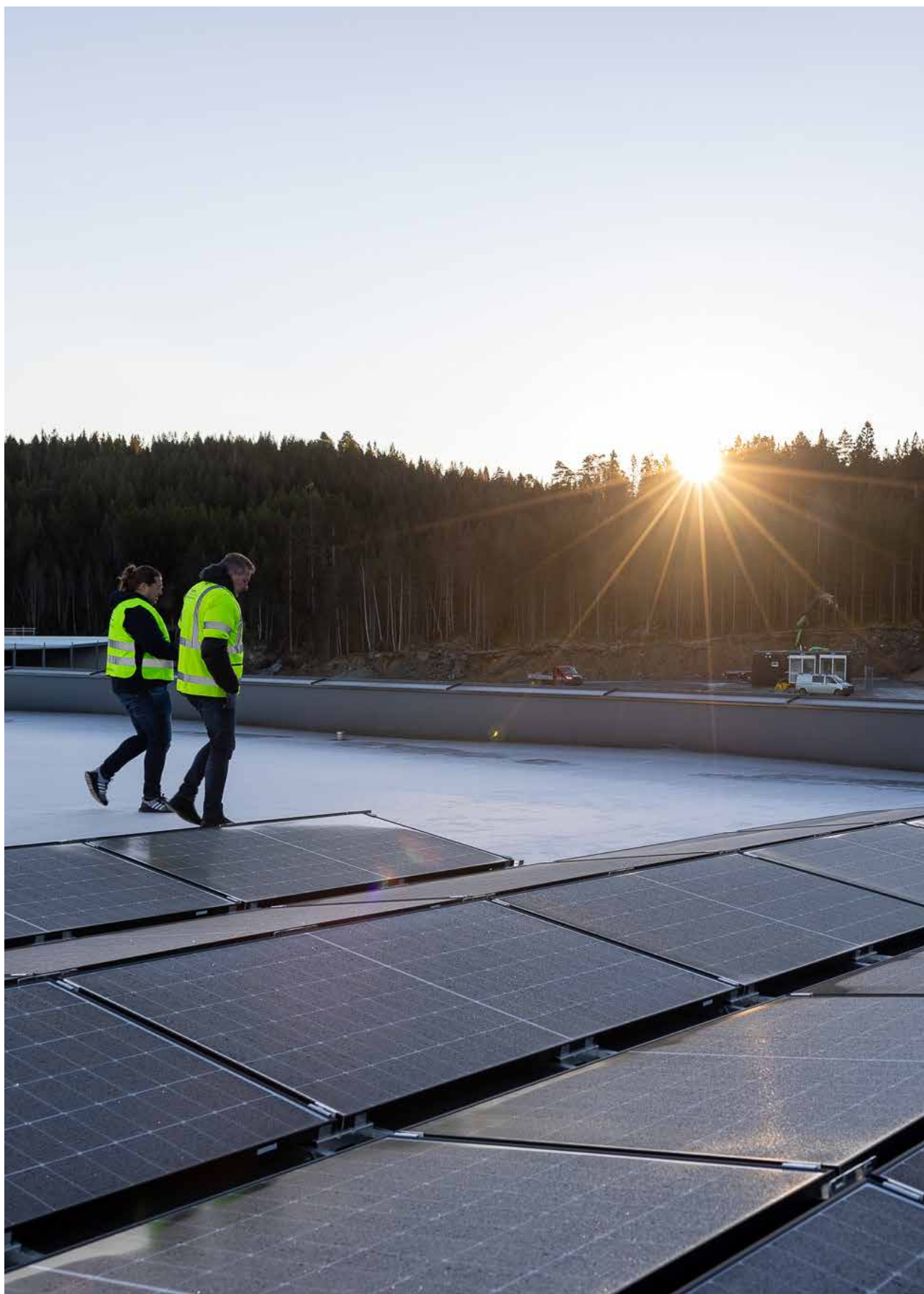
Solcellepanelene som er montert av NTE på taket hos Toyota Material Handling i Trondheim vil produsere ca. 102 000 kWh pr. år.
