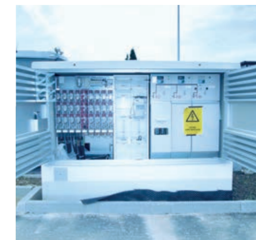
Netze BW projiziert, baut und übernimmt die Betriebsführung für Ihre Mittelspannungs-Anlagen
