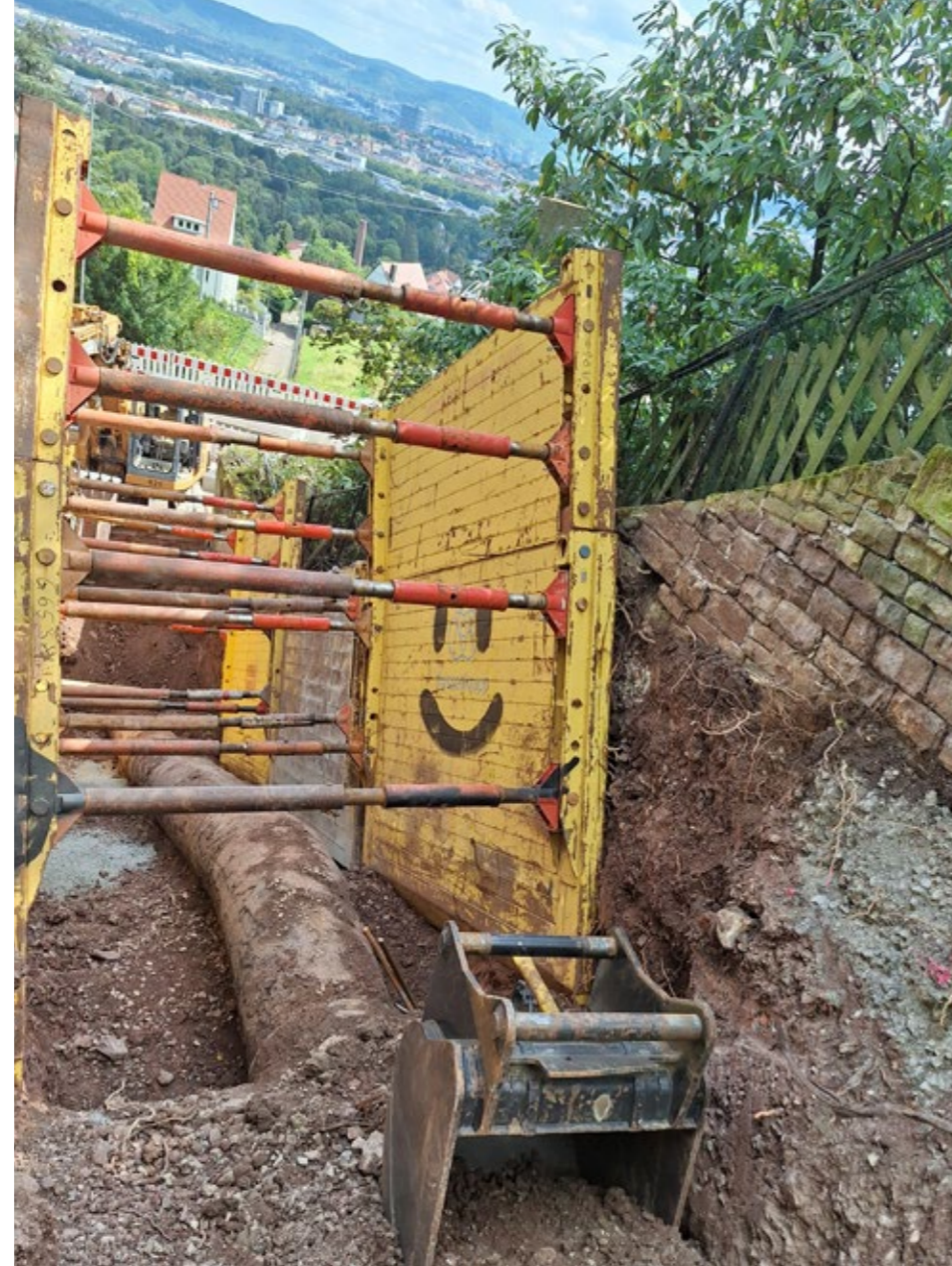
Die Zubringerwasserleitung verbindet die Hochbehälter „Mühlbachhof“ und „Kanonenweg“ und überwindet dabei circa 110 Höhenmeter.
