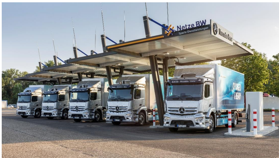
eTruck Charging Park_001: Mercedes-Benz Trucks und Netze BW Sparte Dienstleistungen haben gegenüber dem Branchen-Informations-Center (BIC) im Daimler Truck Werk in Wörth am Rhein einen Demo-Ledepark für eLkw eröffnet.
