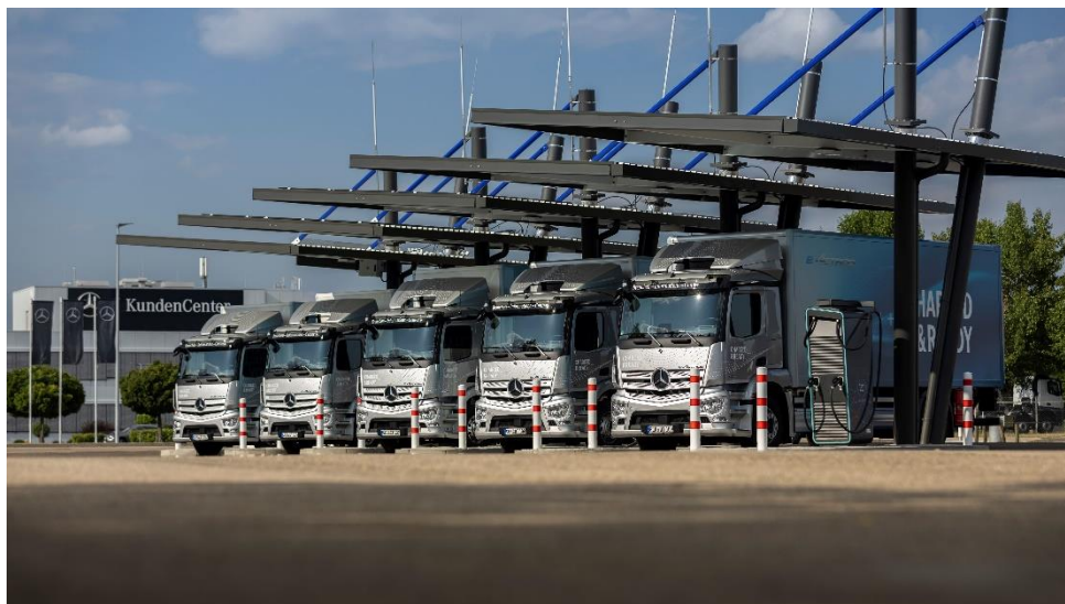
eTruck Charging Park_002: An sechs Ladesäulen verschiedener Hersteller mit Leistungen zwischen 40 kW und 300 kW können eLkw-Kunden im eTruck Charging Park Technologien und Konzepte verschiedener Hersteller testen.
