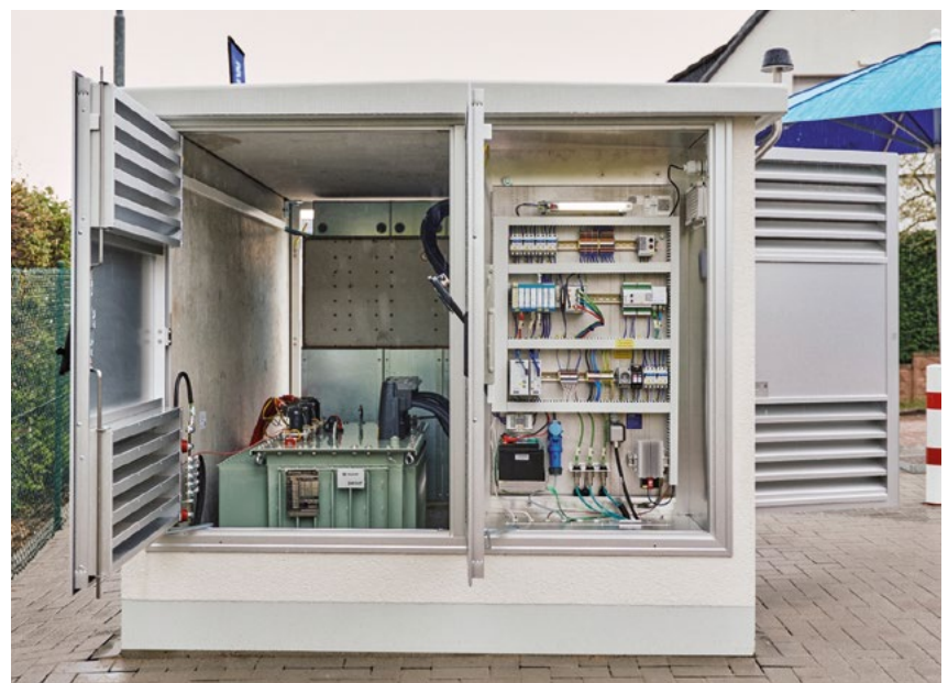
Umspannstation mit Technologien zur Fernmeldung und Fernsteuerung: eine Antwort auf gestiegene Transparenz- und Steuerungsanforderungen im Stromnetz
