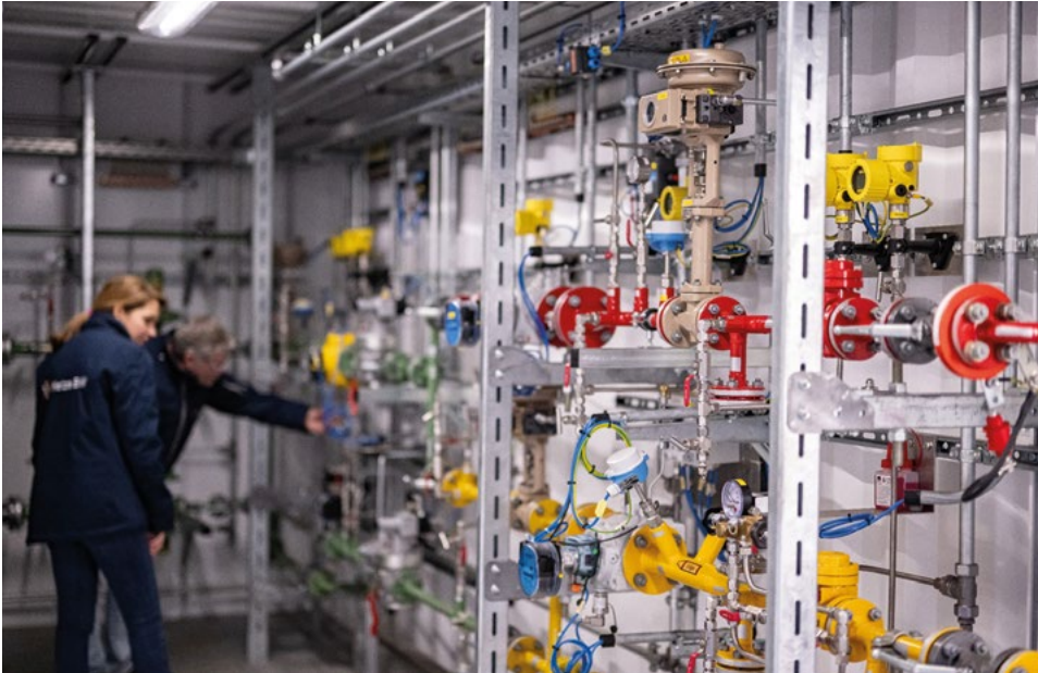
Ein Blick in die Anlagentechnik der Wasserstoff-Insel Öhringen der Netze BW: Praxisnahe Verwendung von vor Ort erzeugtem Wasserstoff in der Wärmeversorgung.
