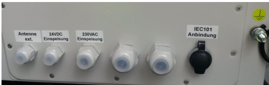
Abbildung 3 Schrankunterseite mit Durchführungen, RJ45-Buchse und Erdungsbolzen
